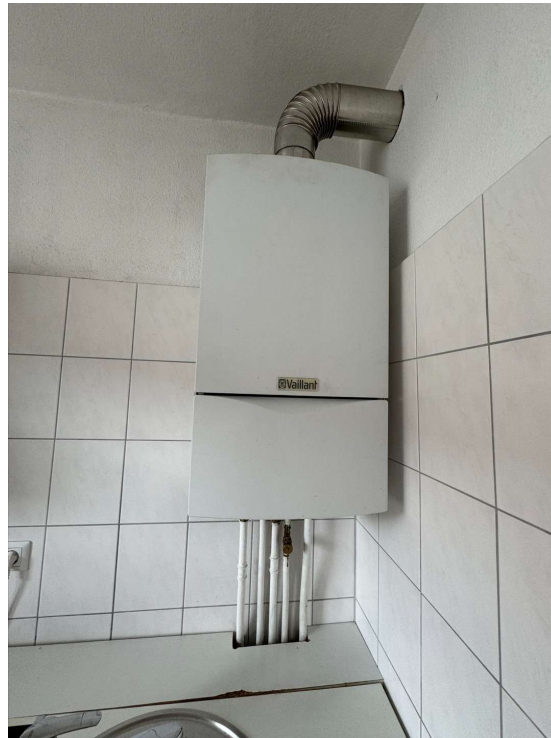
Beheizung mit Gasthermen
