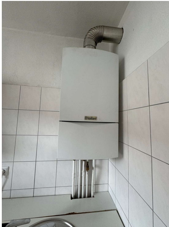
Beheizung mit Gasthermen
